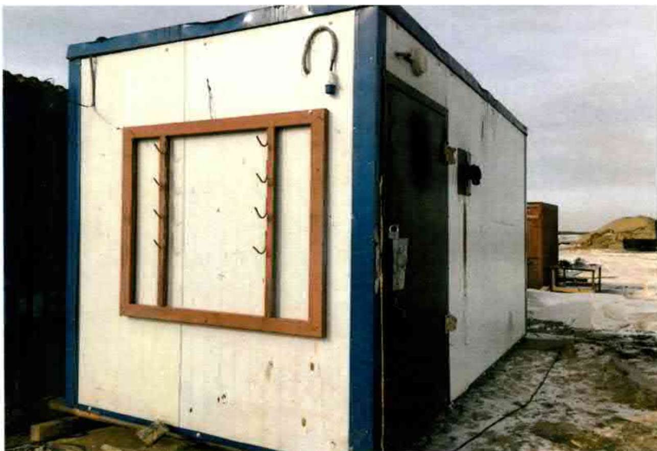
Фото № 17. На стройплощадке в районе моста ПК 49+68 разукomплектован пожарный щит.
