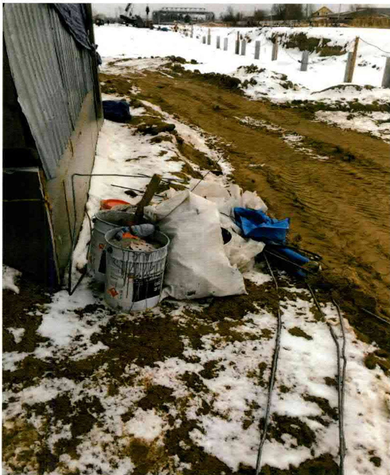
Фото № 21. Захламление территории строительными и бытовыми отходами на стройплощадке в районе ПВП км 17.
