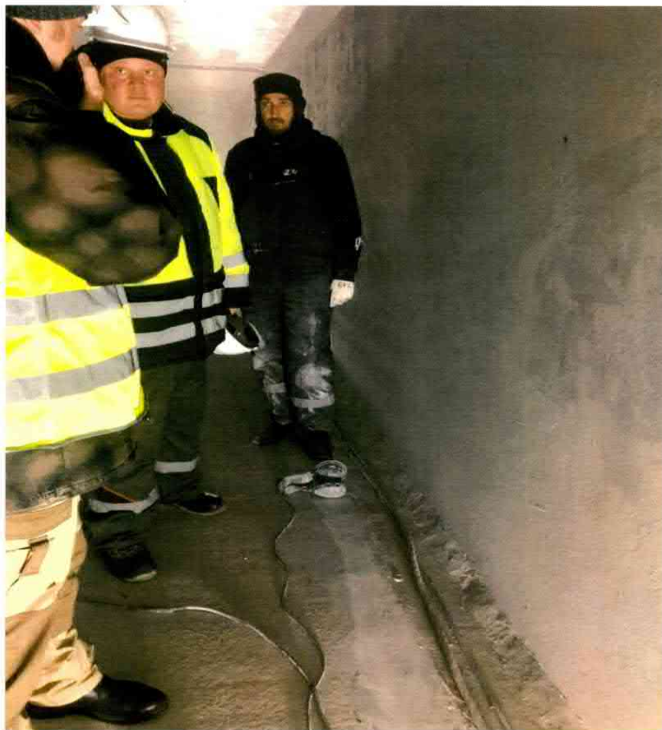
Фото № 14. В районе ПВП км 17 было выявлено отсутствие у работника при производстве строительно-монтажных работ средств индивидуальной защиты.
