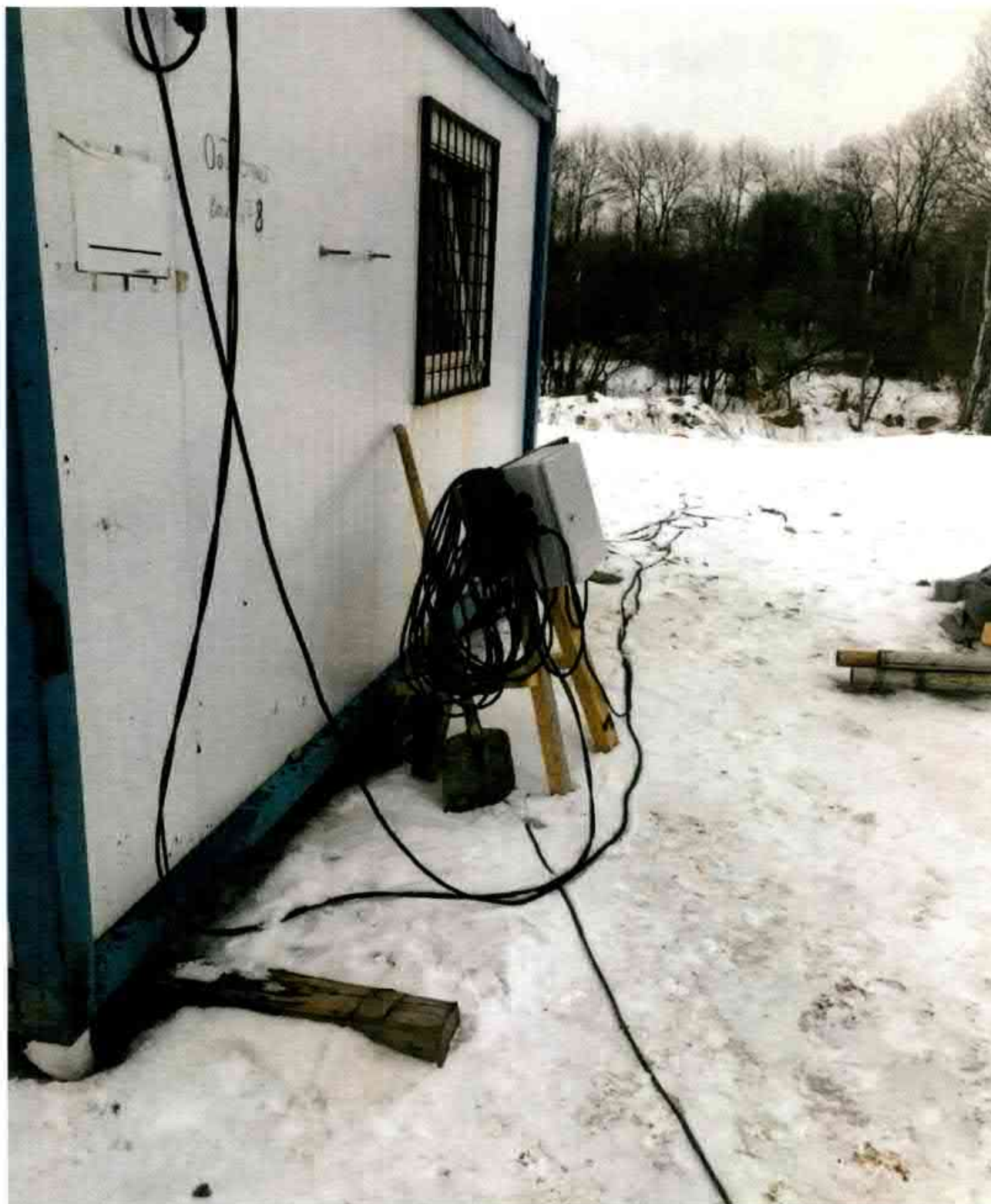
Фото № 7. На строительной площадке в районе моста ПК 111+72 кабель временного электроснабжения проложен по земле.
