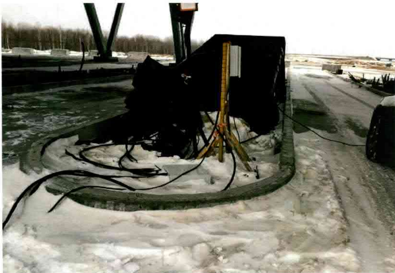
Фото № 4. На строительной площадке в районе строительства ПВП км 22 кабель временного электроснабжения проложен по земле.
