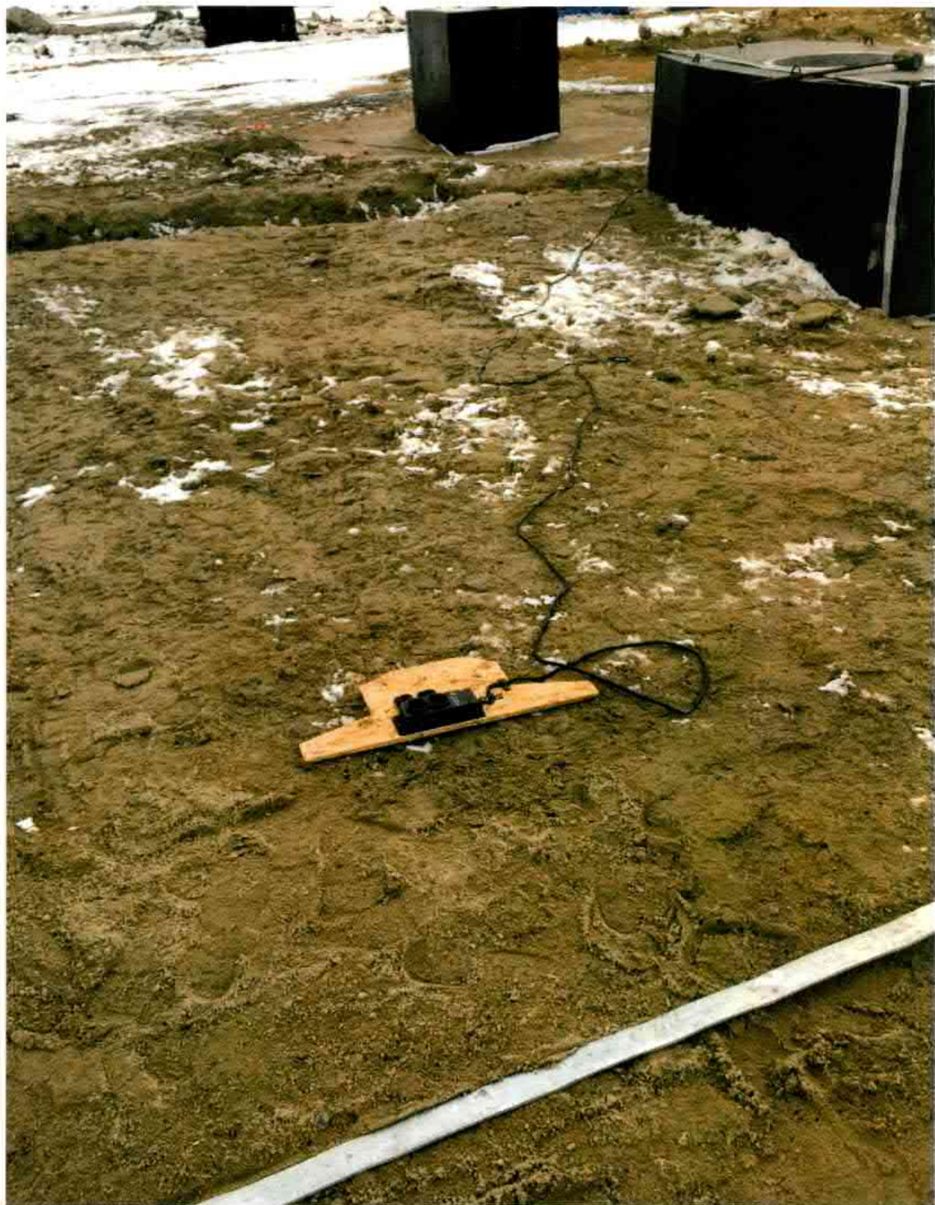
Фото №3. На строительной площадке в районе строительства ГВП км 17 кабель временного электроснабжения проложен по земле.
