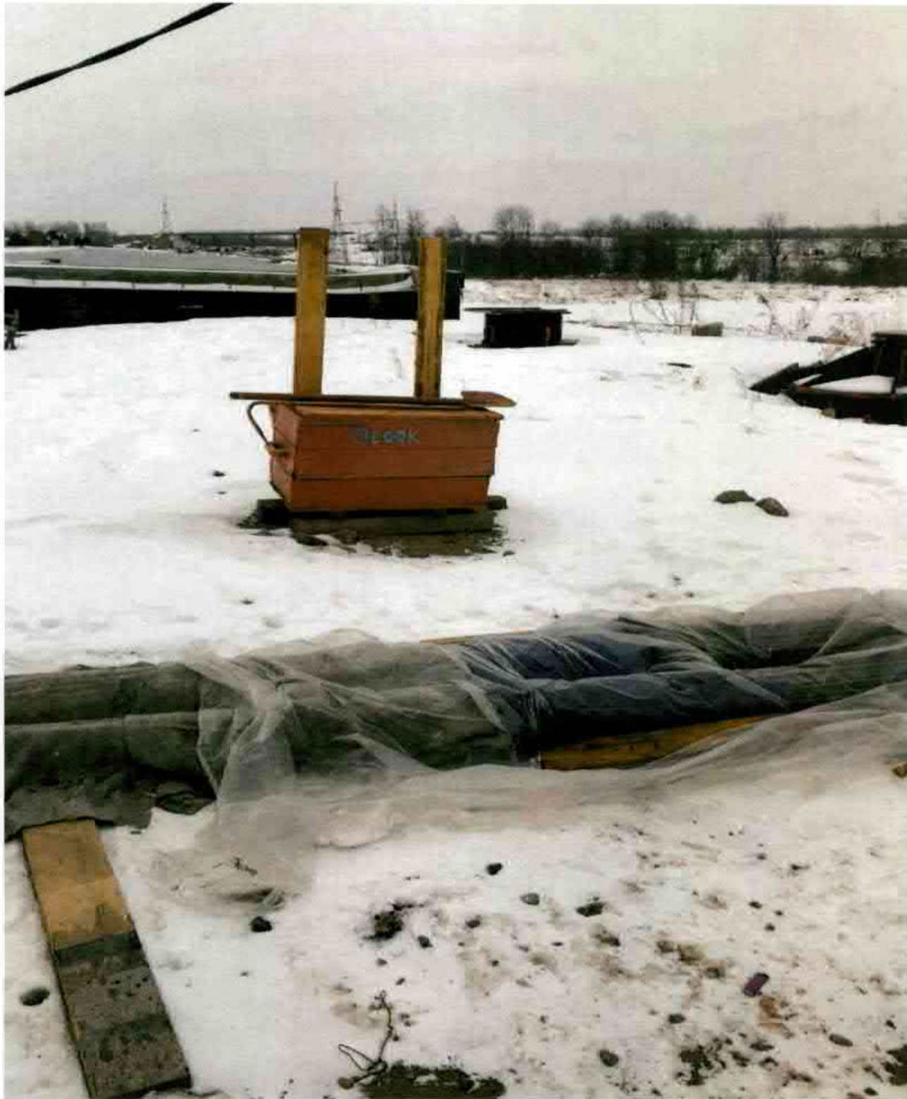
Фото № 18. На стройплощадке в районе моста ПК 111+72 разукomплектован пожарный щит.
