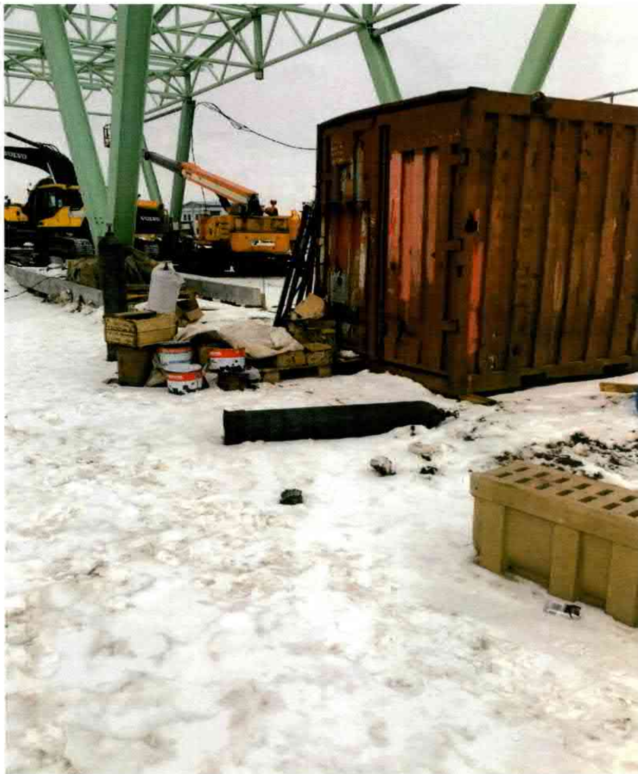
Фото № 9. На стройплощадке в районе ПВП км 22 не соблюдаются правила хранения баллонов, находящихся под давлением.
