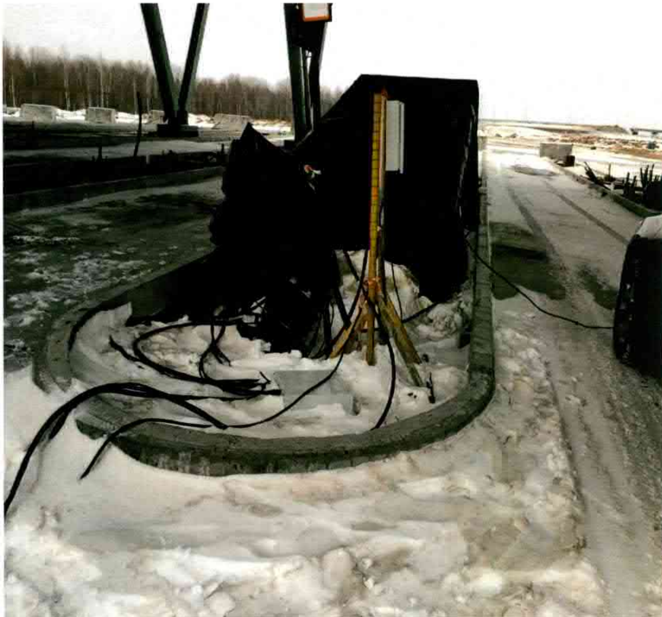
Фото № 2. На строительной площадке в районе строительства ПВП км 15 кабель временного электроснабжения проложен по земле.
