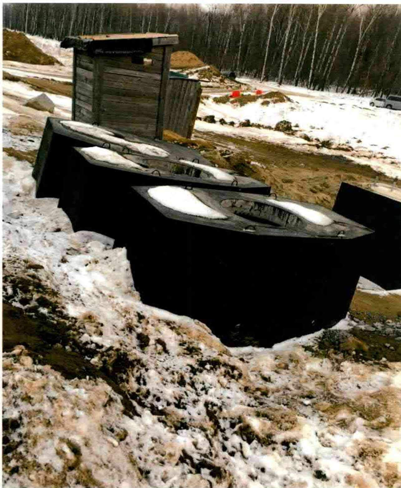
Фото № 22. Хранение железобетонных конструкций (элементы колодцев) в районе стройплощадки ПВП км 37 осуществлялось без применения подкладок или опор.
