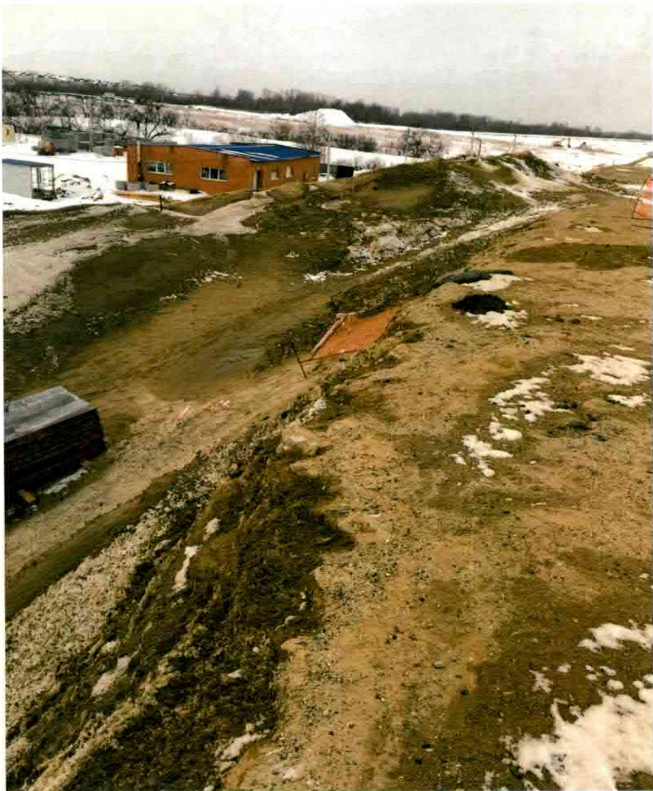
Фото № 16. В районе моста ПК 49+68 было выявлено отсутствие защитного (сигнального), страховочного ограждение зоны производства работ при перепаде по высоте 1,3 м.
