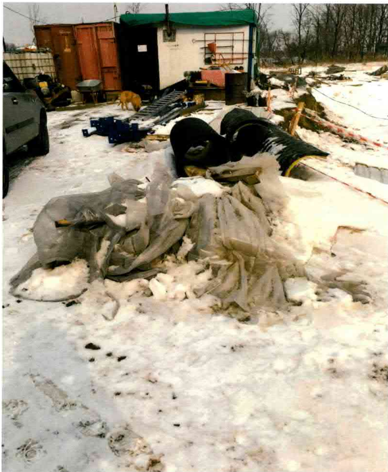
Фото № 20. Захламление территории строительными и бытовыми отходами на стройплощадке в районе моста 6+58.
