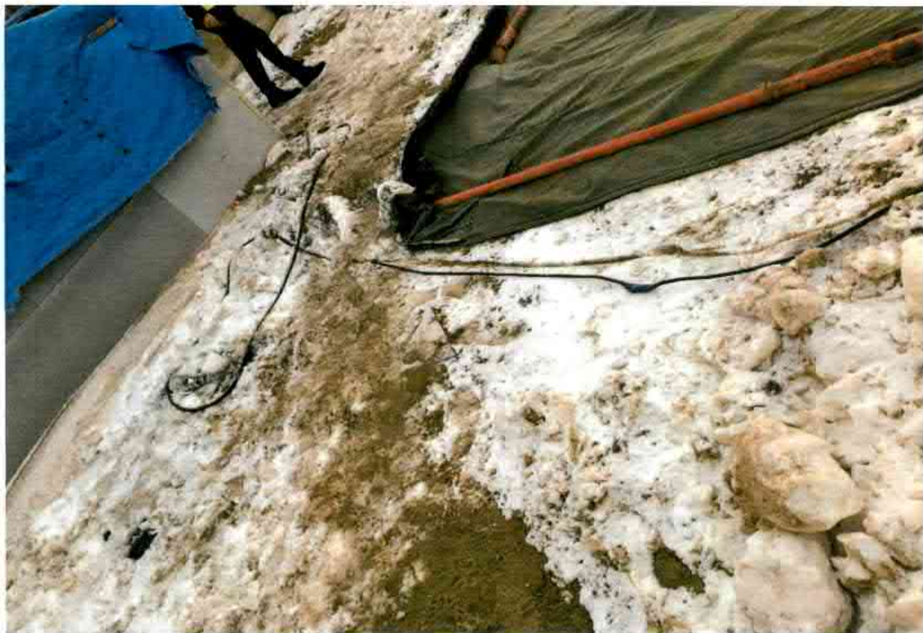
Фото № 5. На строительной площадке в районе строительства ПВП км 37 кабель временного электроснабжения проложен по земле.
